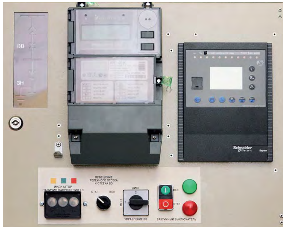
Лицевая панель отсека релейной защиты и автоматики
