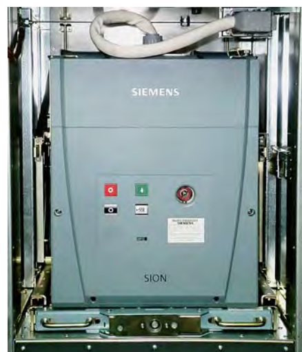
Отсек вакуумного выключателя с SION
