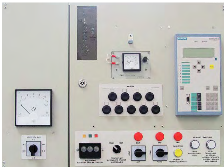
Лицевая панель отсека релейной защиты и автоматики
