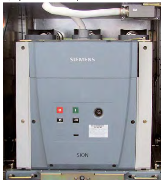
Отсек выкатного элемента с выключателем
