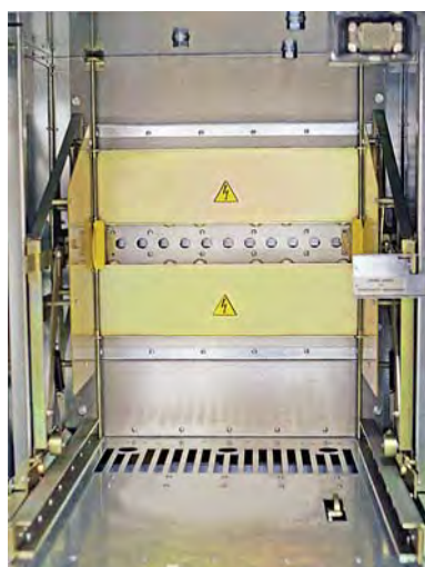
Отсек вакуумного выключателя без SION
